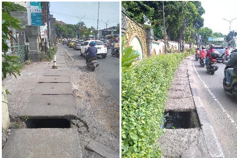
Gambar 14. Lubang dan kerusakan pada Culvert Box di Jl. H. Juanda Sumber: Survei, 2023.
