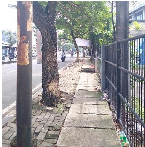
Gambar 13. Permukaan trotoar dan Culvert Box di Jl. H. Juanda Sumber: Survei, 2022.
