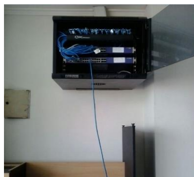
Gambar 2. Lokasi Switch Gedung Satrio Lantai 6
