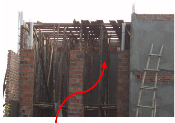
Kayu dolken digunakan sebagai steger. Terlihat pipa dimasukkan kedalam dinding rumah.
