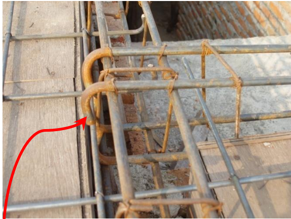
Tekukan pada besi (rencana balok) cukup dalam. Pada gambar ini, kurang pada tekukan besinya.
